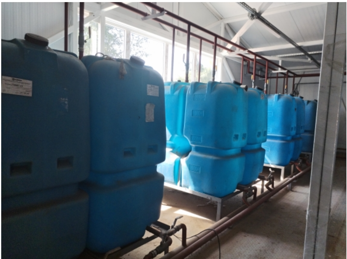
Резервуары для дизельного топлива
