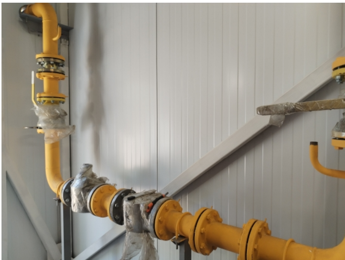
Подача в котельную газа
