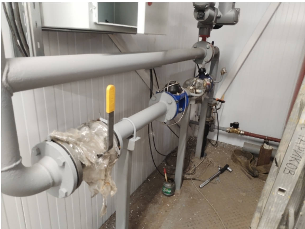
Подача в котельную воды
