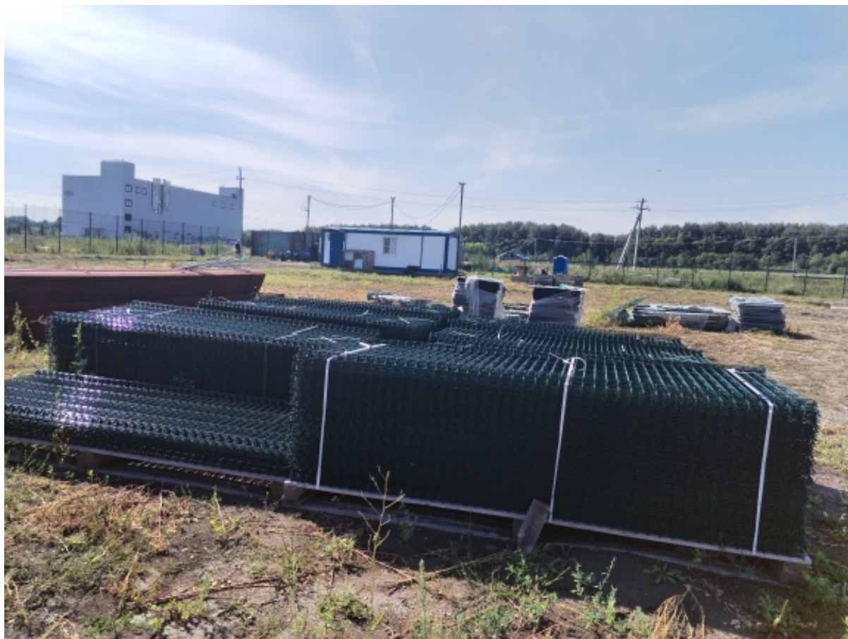
Ограждение для водозаборных скважин
